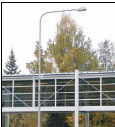
Базовая станция, интегрированная в осветительный столб
