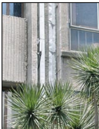
Базовая станция, встроенная в фасад здания
