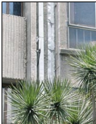
Σταθμός βάσης ενσωματωμένος στην πρόσοψη κτιρίου
