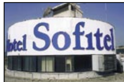
Σταθμός βάσης ενσωματωμένος στην πρόσοψη κτιρίου
